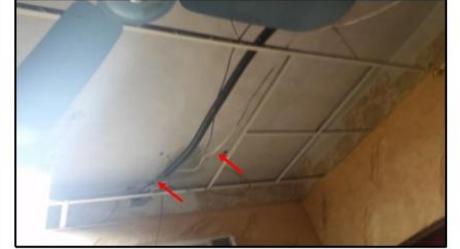
صورة (٢٢): التفرقة بحاجة تركيب سقف مستعاز مع إعادة تمديد اسلاك الكهرباء والتكليف بشكل آمن وإلزام وسد الفتحات.
