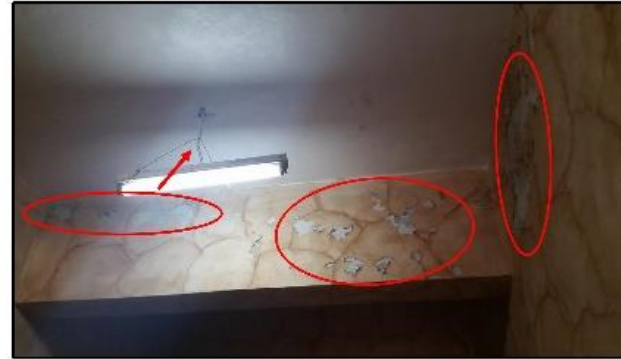
صورة (٢٥): تنتشر الطلاء الداخلي بسبب الرشح مع سوء في التوصيلات الكهربائية وثابت وحدة الإضاءة السقفية.
