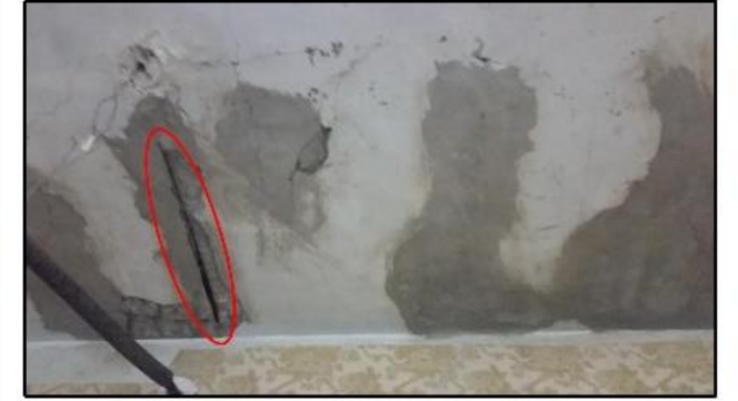
صورة (٢٣): سقوط أجزاء من السقف الخرساني ووجود تلفات نتيجة تسرب المياه رغم محاولة الترميم السابقة.
