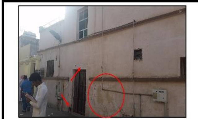
صورة (١): يلاحظ سوء واجهة المبنى حيث يظهر حديد التسليح في الشقوقات حول المبنى وسرّخ فوق باب المدخل نتيجة انهبوط أسفل الباب وتفصل البلوك عن جسر الباب وتفتوت ورشح الطلاء الخارجي نتيجة العوامل الجوية وتسرب الماء.
